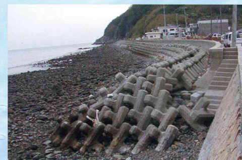
山口県 徳山下松港海岸給島大島護岸 3t型 1973年施工 2007年高上(2007年撮影)
